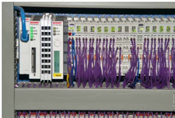
Das CX1010-CPU-Grundmodul ist die Basiseinheit des CX-Systems von Beckhoff, mit zugehörigen Busklemmen.
