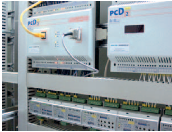
Gebäudeautomation mit SAIA-SPS und Ethernet-Kommunikation.
