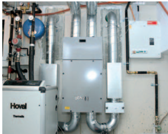
Wärmepumpe und kontrollierte Wohnraumlüftung.
