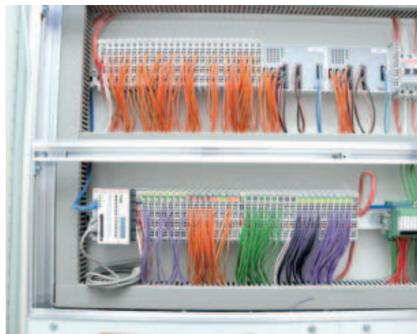
Haussteuerung aus einem Guss: Beckhoff-Ethernet-I/O-System mit Ethernet-Kommunikation und Zentralrechner; in der oberen Reihe die Spezialmodule von Schenker Storen.
