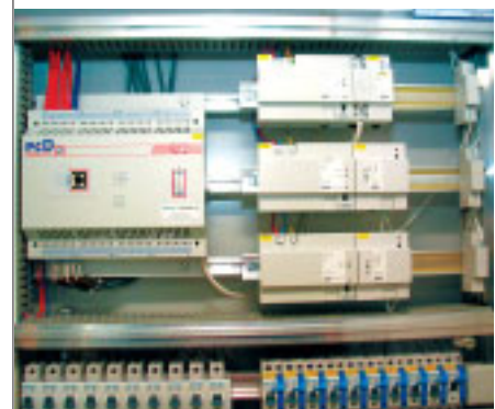
Bild 2: Teamwork von Saia-SPS und EIB in den Etagenverteilungen. (Foto: BUS-House)
