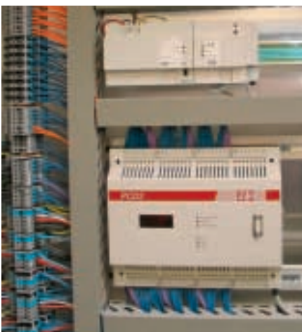
Die Frage: Sind alle Geräte richtig angeschlossen?
